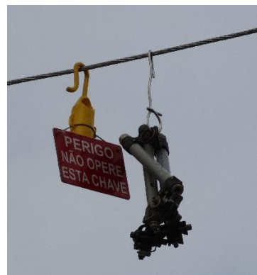
Foto demonstrando porta fusível e placa de sinalização pendurada no neutro
