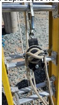
Foto demonstrando a carretilha travada preparada para retirar o trava-quedas e talabarte da vítima.
