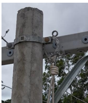
Foto demonstrando a ancoragem da linha de vida na cinta da estrutura
