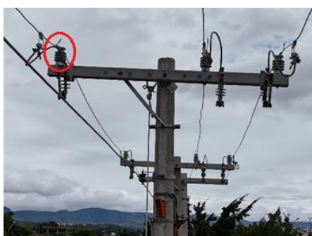
Foto demonstrando o isolador a ser substituído.
