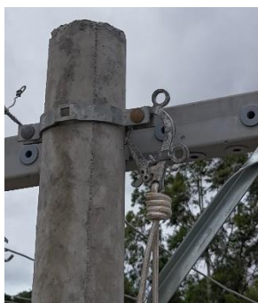
Foto demonstrando a ancoragem da linha de vida na cinta da estrutura
