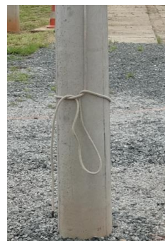
Foto demonstrando a linha de vida amarrada na base do poste
