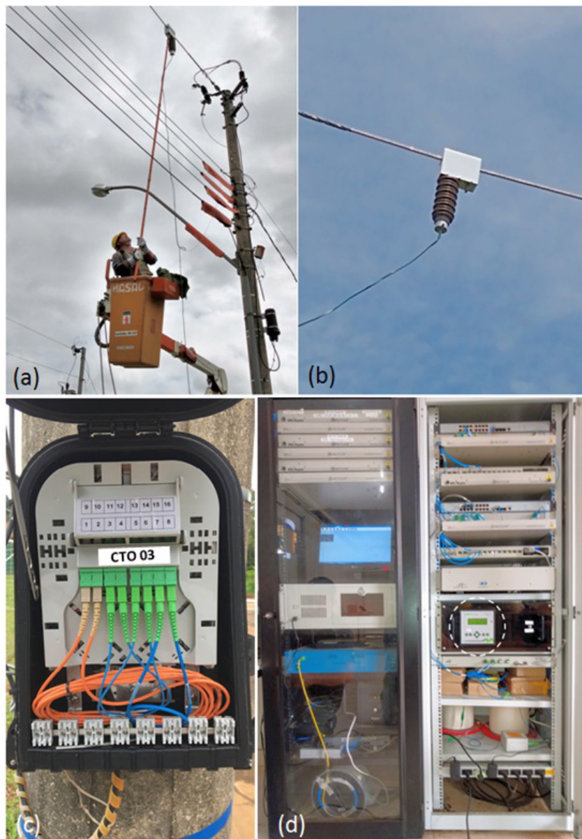
Figura 8 – (a) Instalação no sensor no condutor sinérgico, (b) sensor instalado, (c) caixa de terminação óptica a qual o sensor se conectou as fibras da rede sinérgica e (d) rack no LTO onde a unidade de processamento e o equipamento MQ-700 foram instalados.
